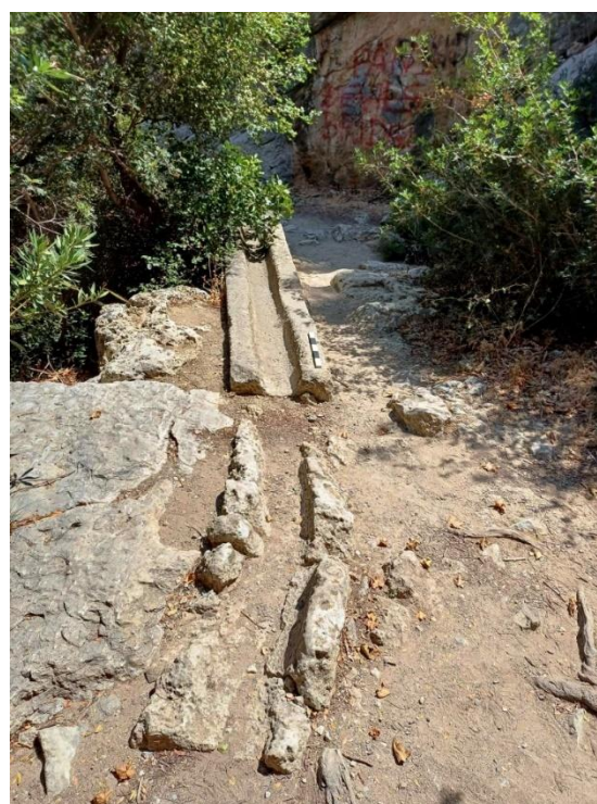
Εικόνα 8. Η σύνδεση του λαξευμένου στον βράχο αγωγού με τον μονολιθικό αγωγό από τραχείτη πάνω στη γέφυρα.
