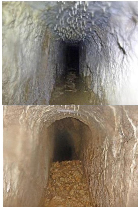
Εικόνα 12. Σταλακτιτικοί σχηματισμοί στην οροφή της σήραγγας. Κάτω, καταπτώσεις χαλαρών σχηματισμών.
