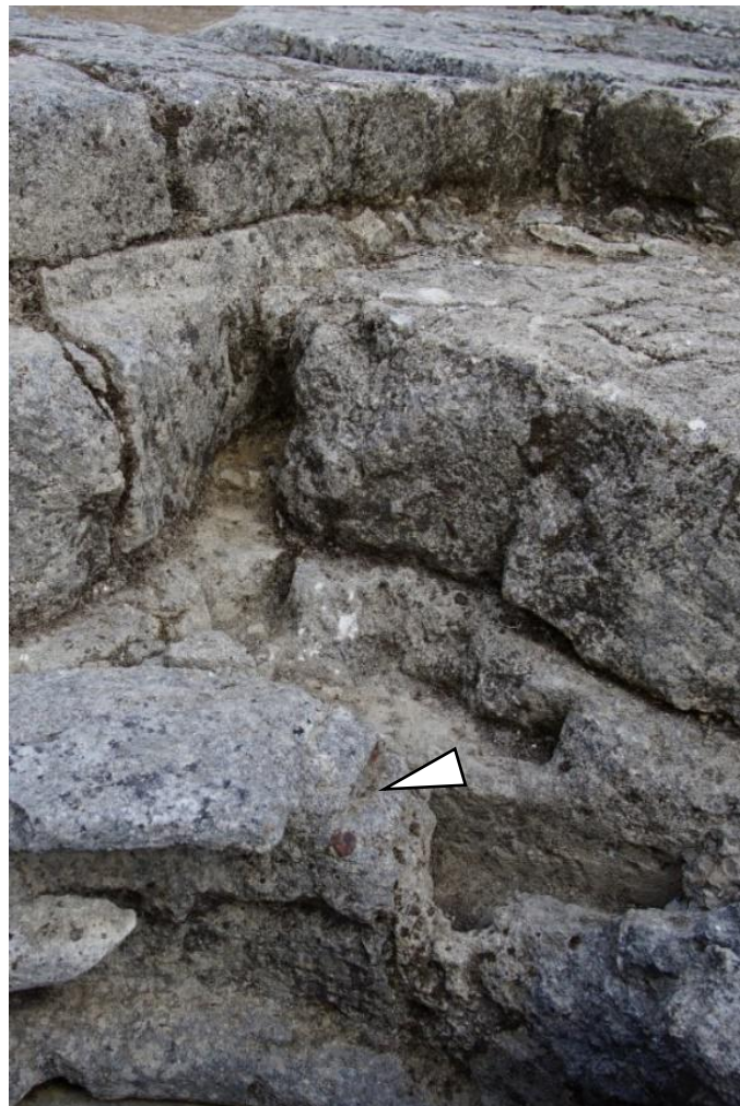
Εικ. 9. Η περιοχή ένθεσης του βόρειου μεταλλικού συμπλέγματος. Με λευκό βέλος σημειώνεται η εγκάρσια εντορμία επί του ανώτερου τμήματος του περικοχλίου. Προς το εσωτερικό του περικοχλίου διακρίνεται ίχνος σκουριάς.
