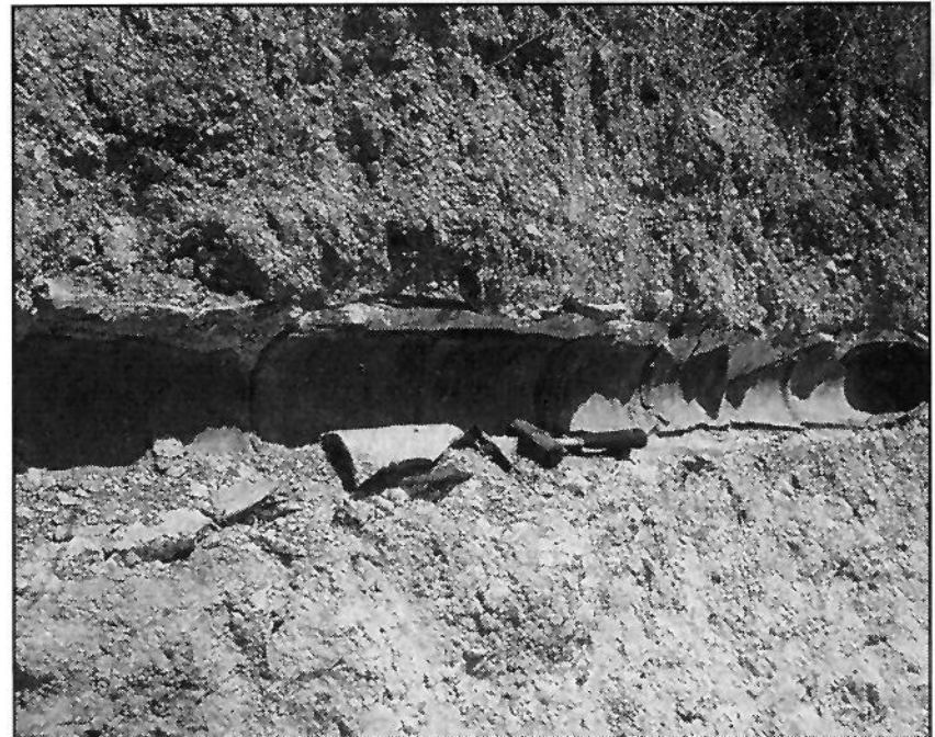
Το τούνελ του κανάτ Νέας Ζίχνης με μήκος μεγαλύτερο από 1.000 μ. Το νερό από το τούνελ οδηγείται μέχρι το 1980 στους κυλινδρικού σχήματος πήλινους αγωγούς και από αυτούς σε βρύσες που ύδρευαν την κωμόπολη Νέας Ζίχνης. Μετά το 1980, οι αγωγοί αντικαταστάθηκαν με σύγχρονους πλαστικούς.
