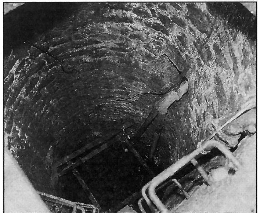
Το πηγάδι της φωτογραφίας ανήκει σ' ένα από τα κανάτ του Σιδ. Σταθμού Αγγίστας Σερρών, που κάλυπτε τις ανάγκες σε νερό των ατμομηχανών μέχρι το 1935. Σήμερα, το πηγάδι καλύπτει τις ανάγκες ύδρευσης του ομώνυμου χωριού.
